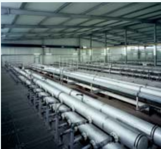
Membranbelebungsbecken auf der Kläranlage Nordkanal des Erftverbandes.
